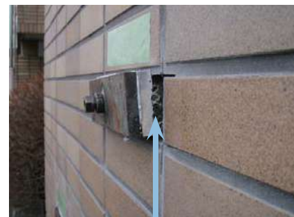
2次破断（投錨効果が発現） 1次破断で割れたタイルを立体繊維が繋ぎ留める
