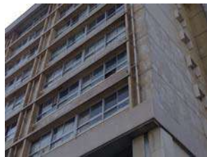
透明樹脂工法経年劣化 (例)
